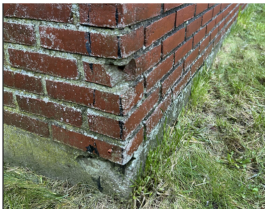
Eksempel på fugt i murværk
